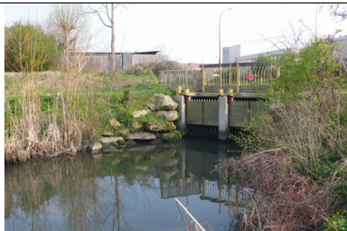
Figure 32 Vannes de régulation et d'amenée d'eau en amont du segment de Bièvre réouvert
